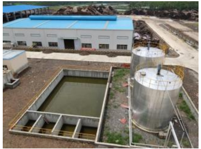
甲醛储罐和应急事故池
