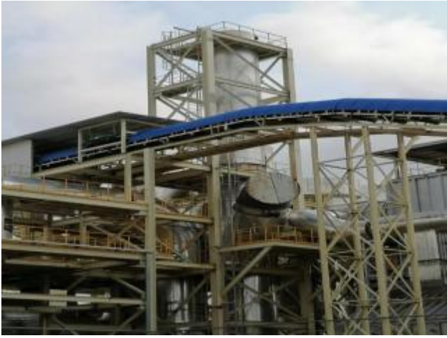
干燥线尾气排气筒
