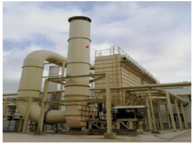
砂光布袋除尘排气筒
