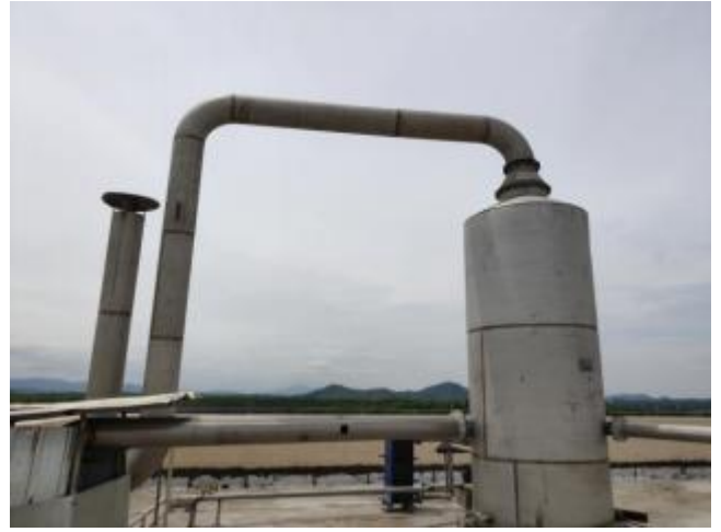
制胶车间排气筒
